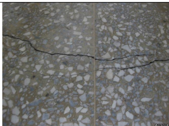
圖說：圖為目前實驗室地面多處龜裂
