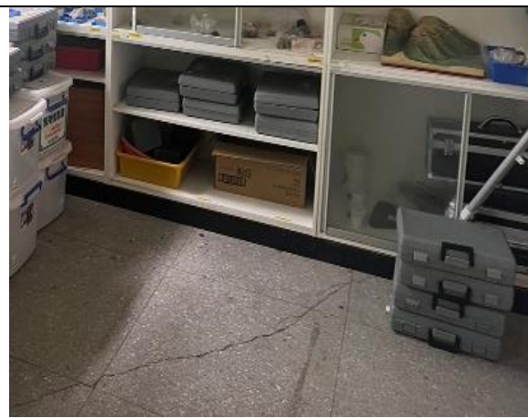
圖說：圖為目前實驗室地面多處龜裂
