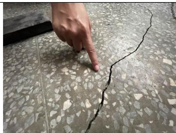
圖說：圖為目前實驗室地面多處龜裂
